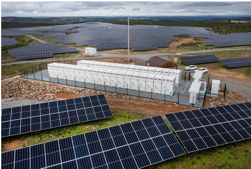
España instala en el sistema eléctrico en enero más baterías que en el último trienio
