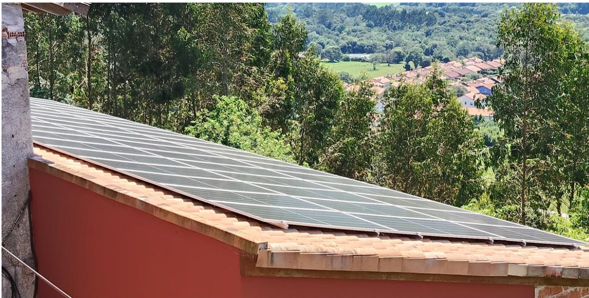
Energía solar fotovoltaica
