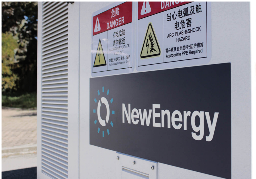
Instalaciones de almacenamiento de CR New Energy.
