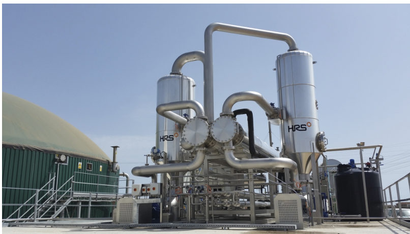
El sistema de concentración de digestato de HRS (DCS) reduce el volumen del digestato y las emisiones de amoníaco.
