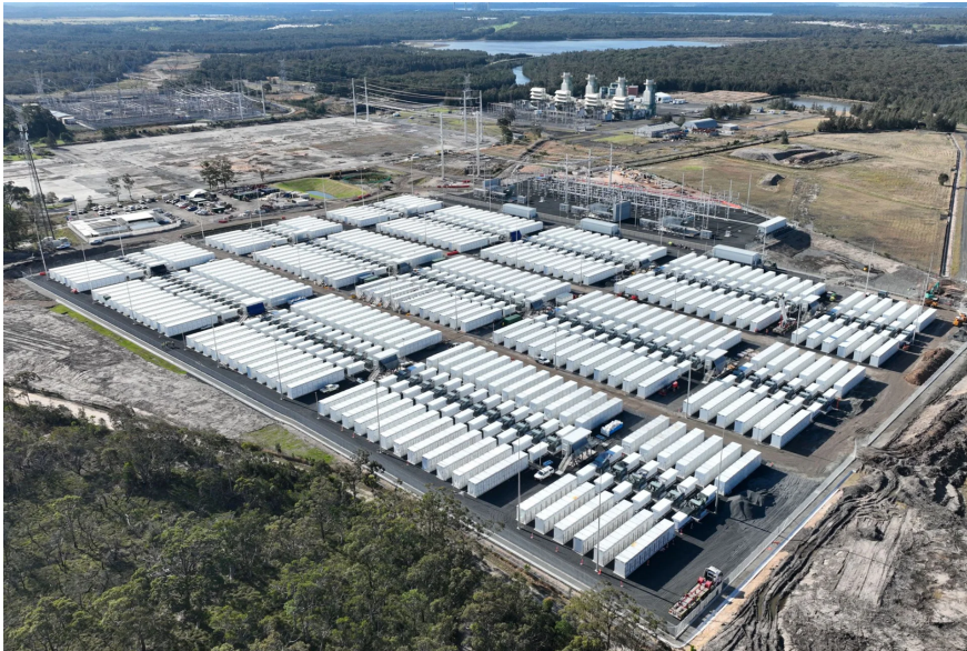
La batería más potente de Australia culmina su construcción y ya opera a plena capacidad
