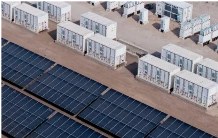
El almacenamiento de electricidad en baterías se dispara en la Unión Europea
