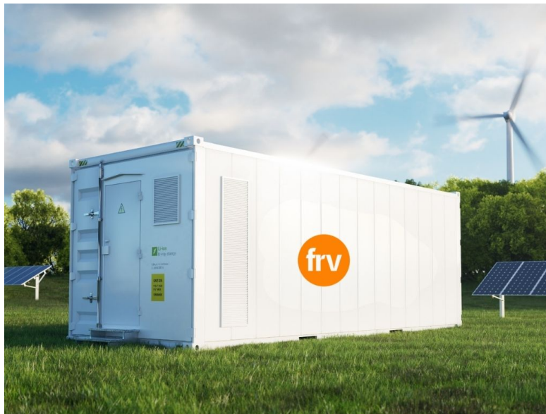
FRV proyecta más de 1,2 GW y 5 GWh en almacenamiento BESS en España.
