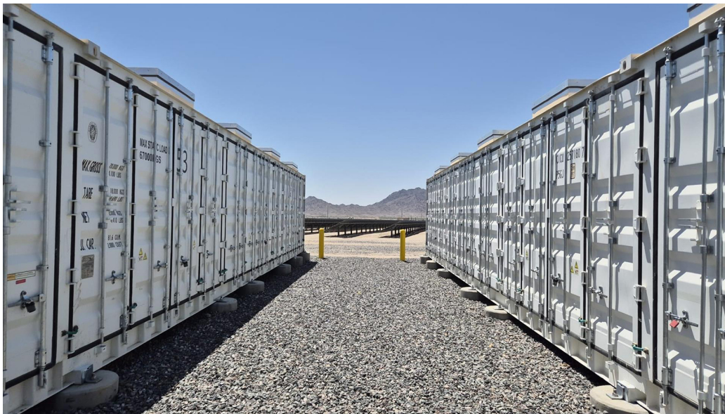
Instalación de almacenamiento en baterías de Power Electronics en EEUU.
