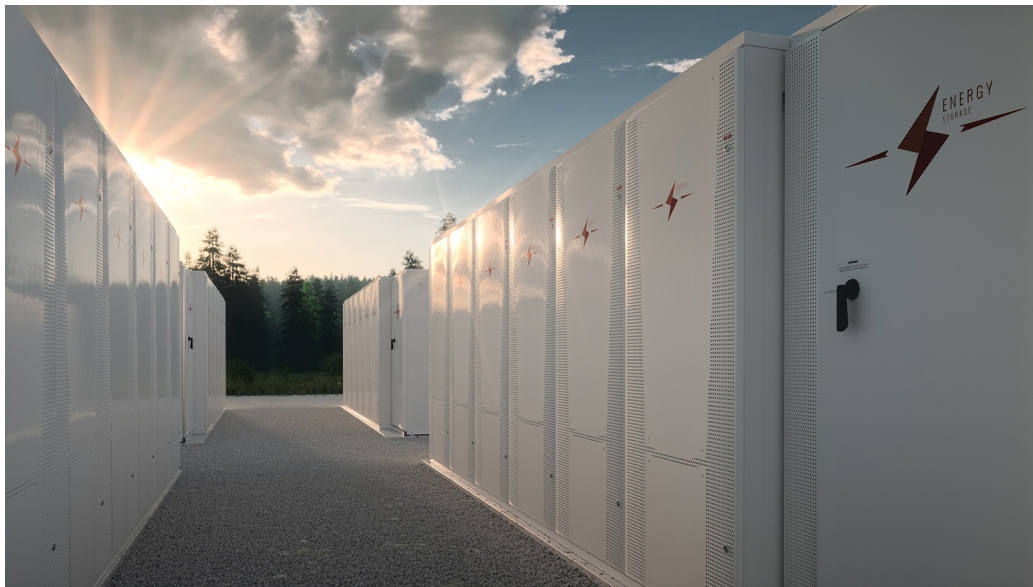
FRV Australia obtiene los permisos para el desarrollo de un sistema de baterías de 1440 MWh en Nueva Gales del Sur.
