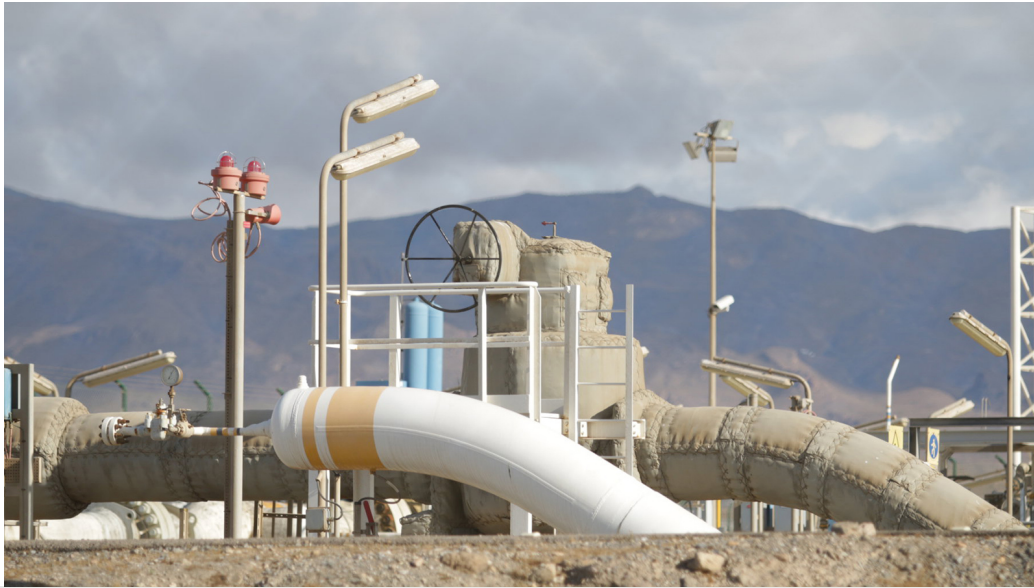
Instalaciones del gasoducto Medgaz Almería-Chinchilla. A 11 de noviembre de 2022, en Almería (Andalucía, España).
