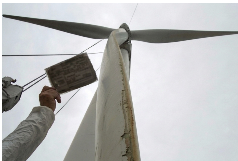
Pala eólica con erosión en el borde de ataque.
