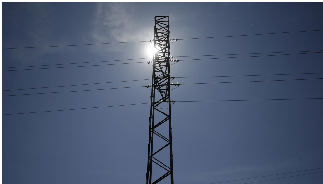
Una torre de alta tensión durante el apagón.
