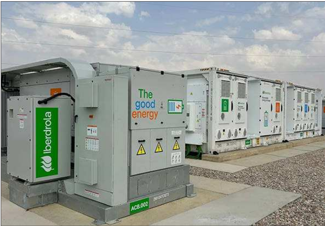
Sistema de almacenamiento a través de baterías (BESS) en España. EE
