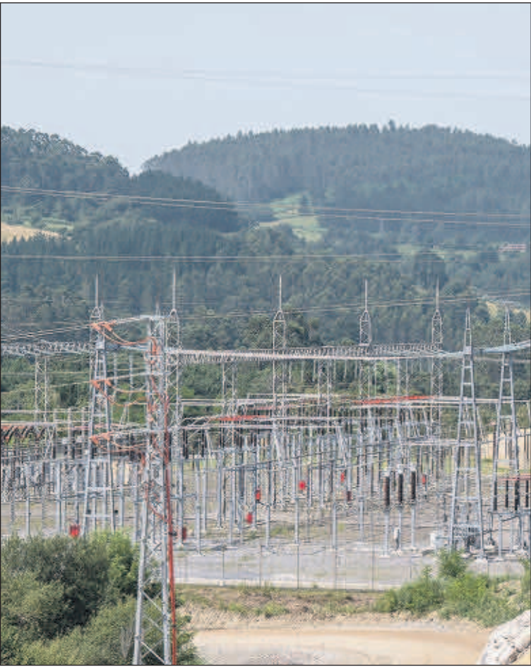
Una subestación eléctrica. EE
