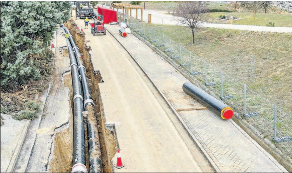
La energía térmica se distribuye a varios edificios a través de una red de tuberías subterráneas.
