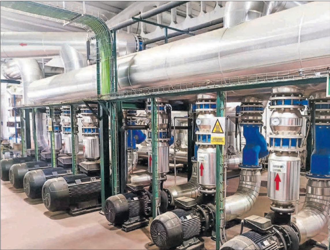
La red de calor es un sistema centralizado que produce energía térmica en una instalación común.
