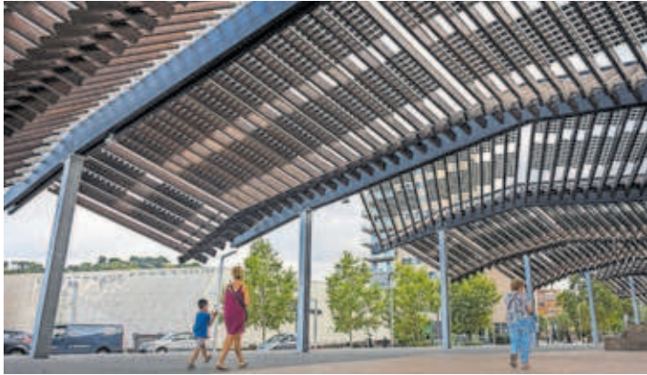
Instalaciones fotovoltaicas municipales en Ronda de Dalt, Barcelona. GIANLUCA BATTISTA
