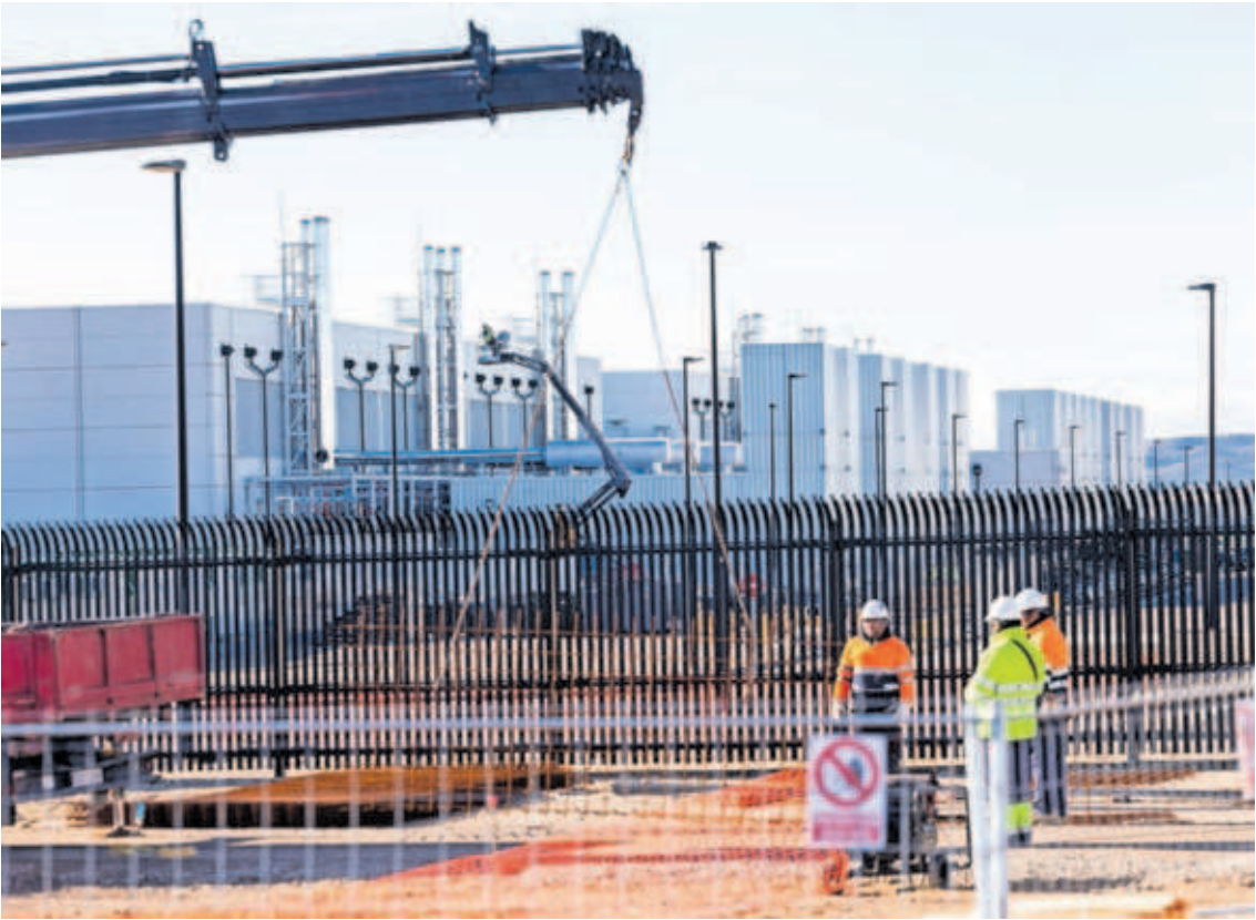
Centro de datos de Amazon en Villanueva del Gállego (Zaragoza), el 22 de enero. CARLOS ROSILLO
