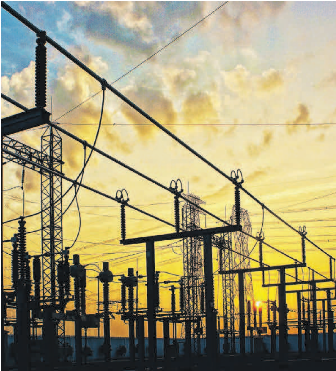
Una subestación eléctrica. GETTY
