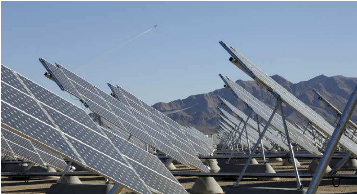
Instalación solar. eE
