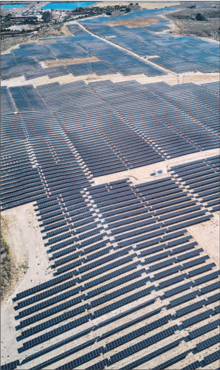
Parque fotovoltaico. EE
