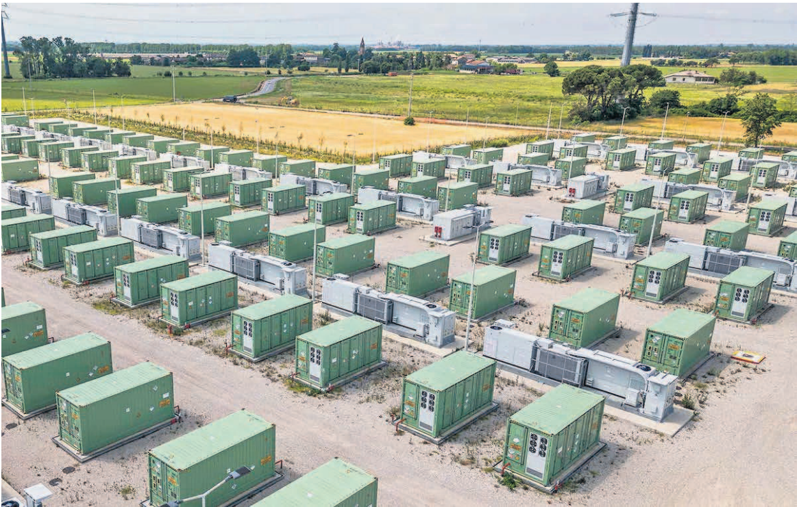
FOTO DE ARCHIVO DE CONTENEDORES DE BATERÍAS BESS. DA
