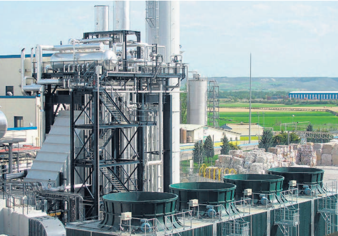
Una planta de cogeneración en una industria española
