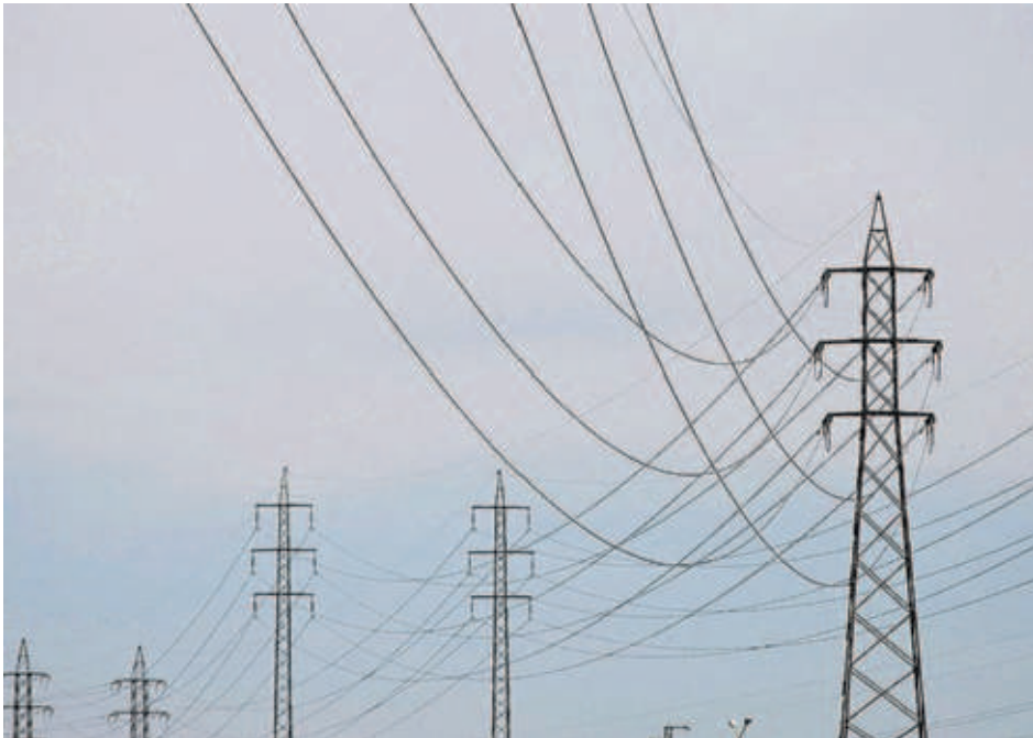
Red de alta tensión de REE en Sevilla. PACO PUENTES
