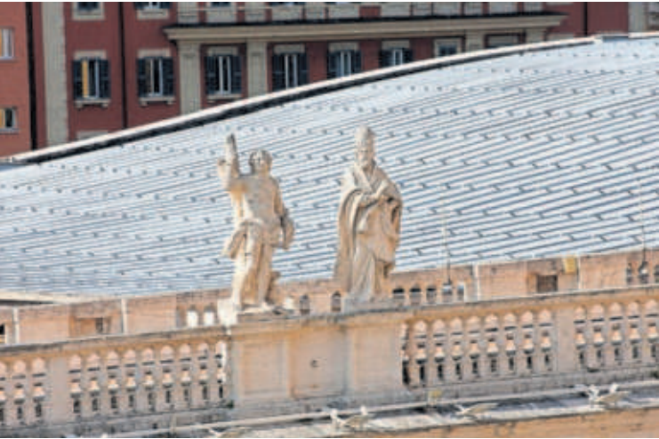
Paneles solares en una cubierta del Vaticano. FRANCO ORIGLIA (GETTY)
