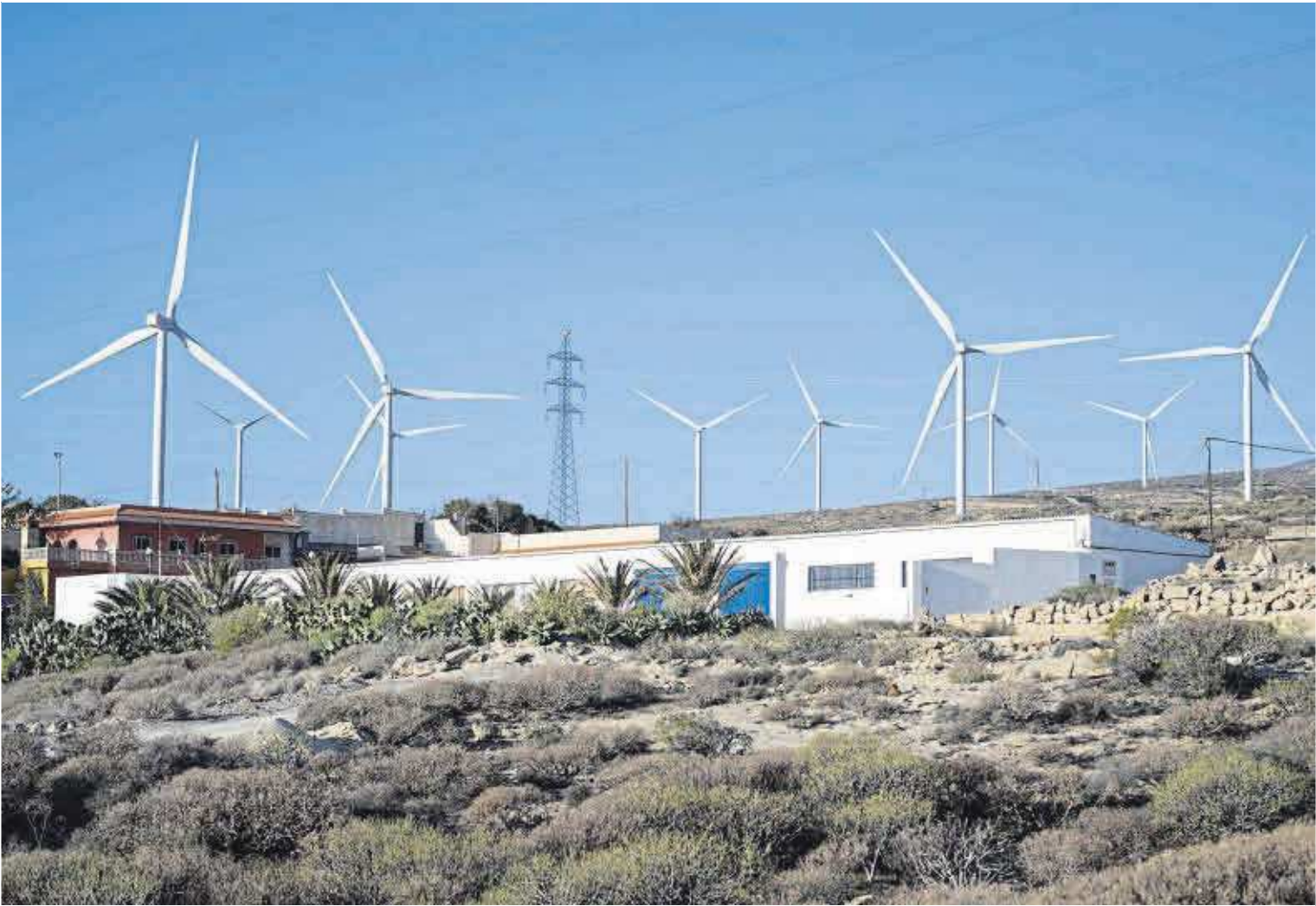
Molinos de un parque eólico ubicado en Fasnía.
