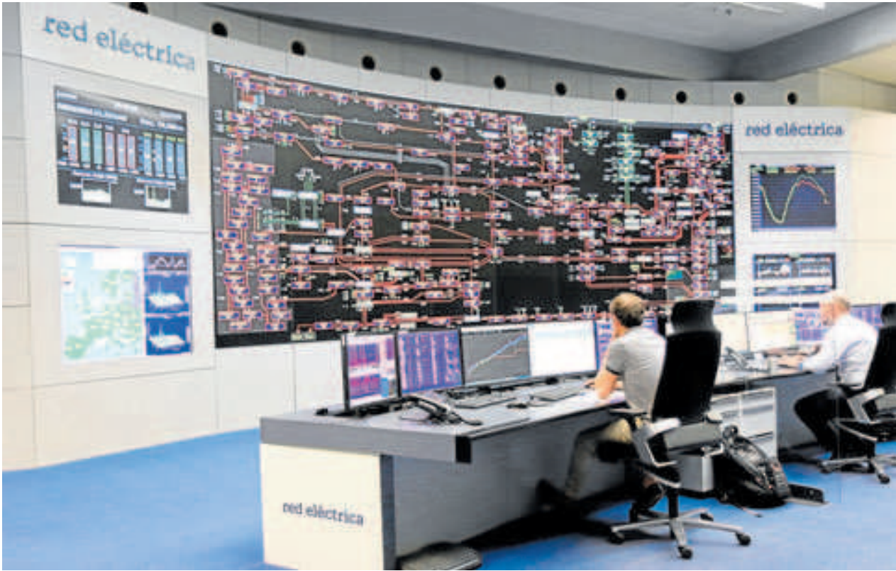
Centro de control de Red Eléctrica. ABC
