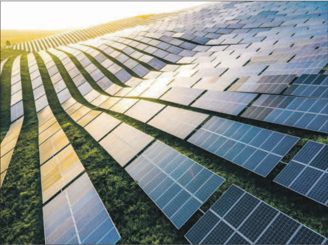
Una instalación de placas solares. ISTOCK
