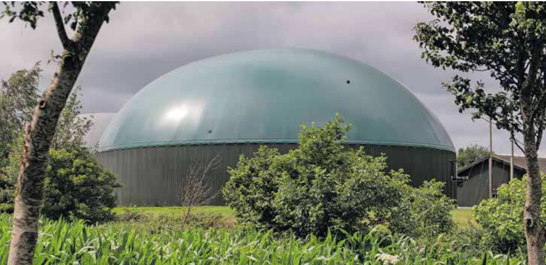
Los depósitos de biogás permiten transformar residuos orgánicos en un recurso energético gestionable.
