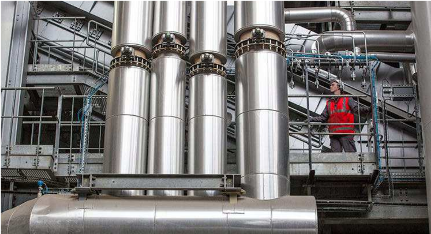
A través de pozos perforados a gran profundidad, los sistemas de geotermia proporcionan climatización y agua caliente sanitaria.
