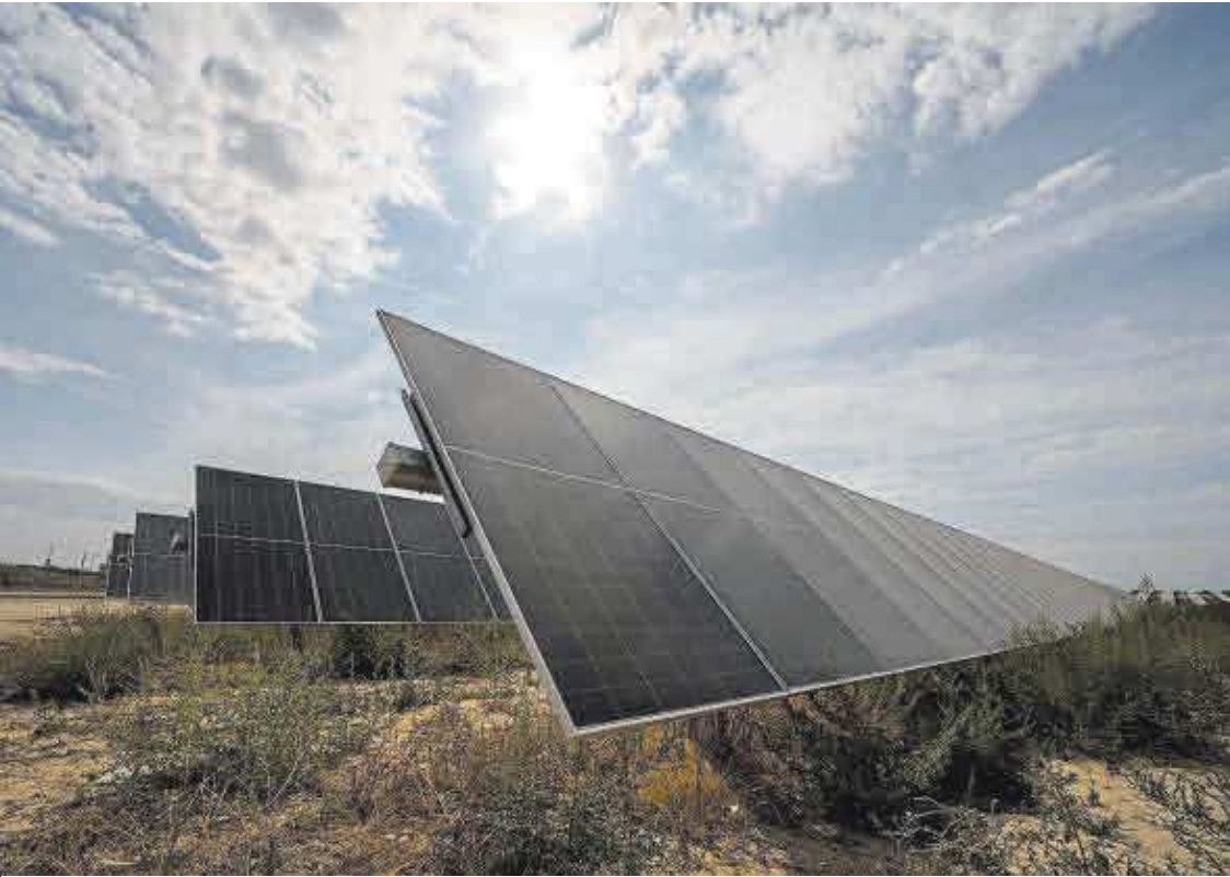
Parque de placas solares en Alcarràs.
