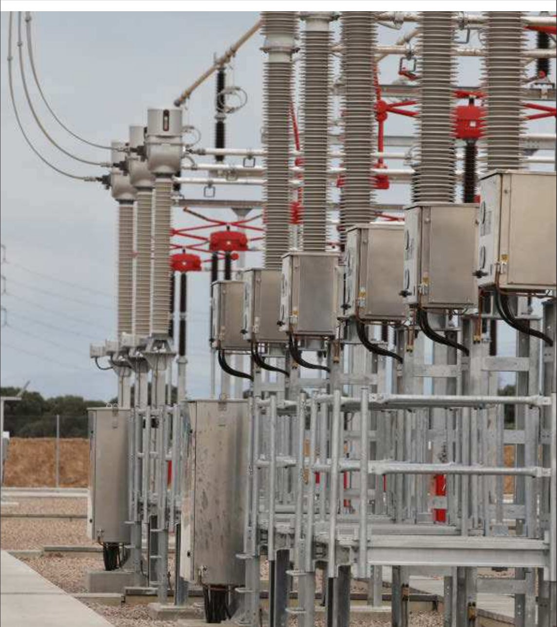
Una subestación eléctrica de media tensión. EP
