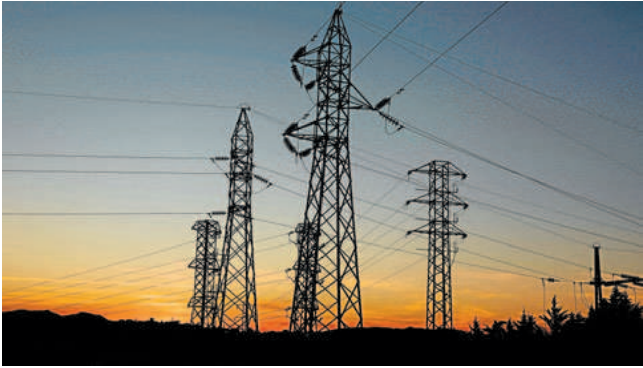
Líneas de alta tensión en Ronda, Málaga. Reuters
