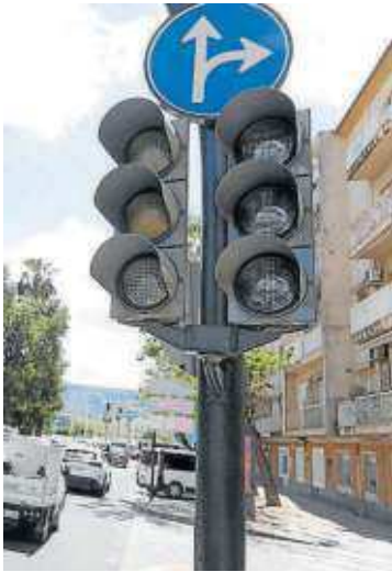
Un semáforo apagado. Foto: E.P.
