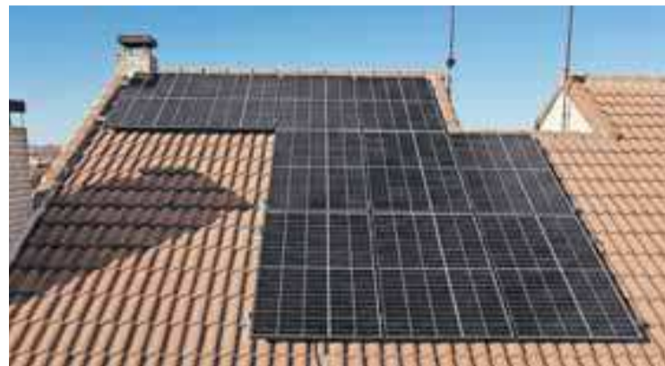
Instalación solar sobre una vivienda.
