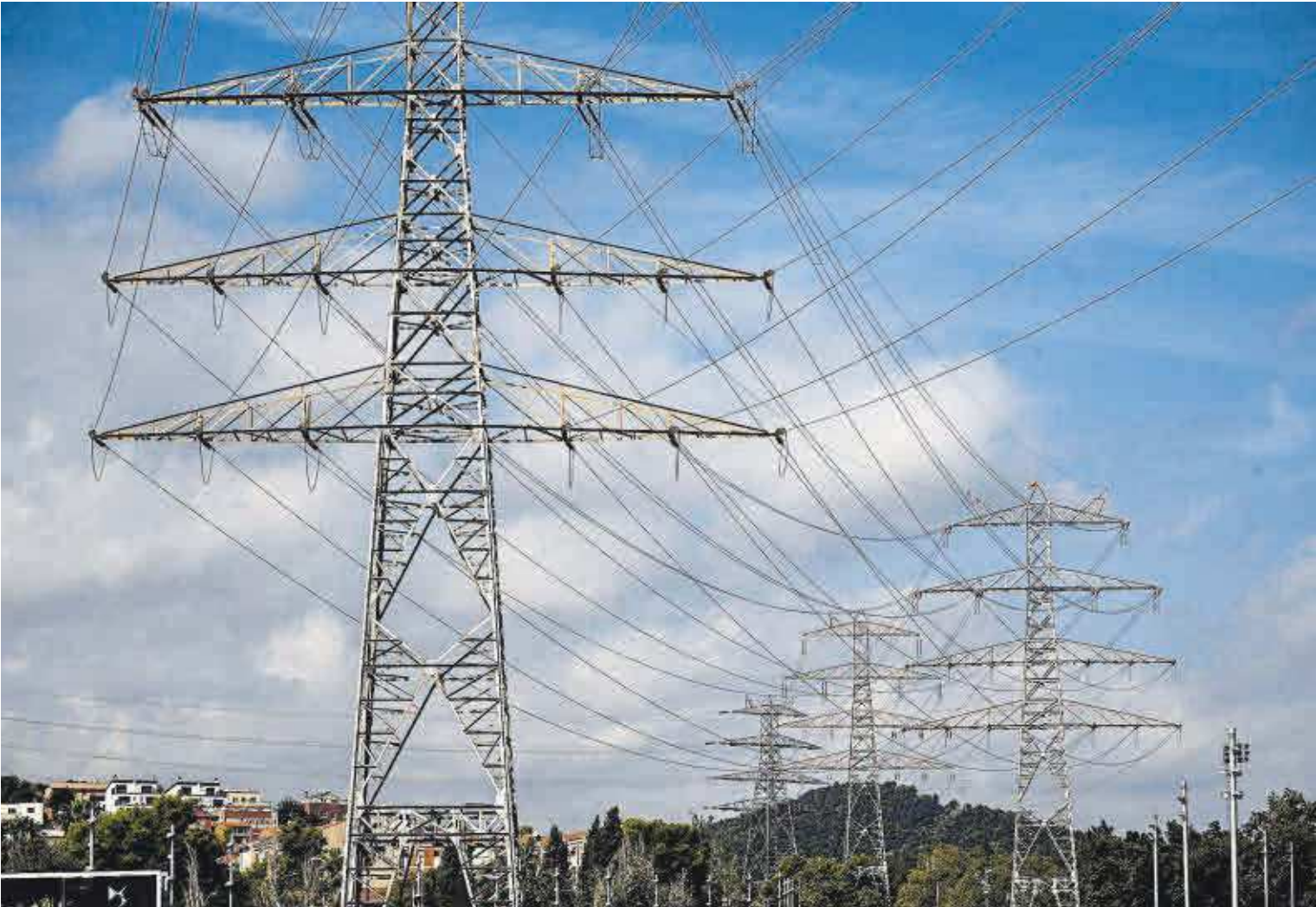
Torres eléctricas de alta tensión en la ronda de Sant Ramón, en la localidad de Sant Boi.
