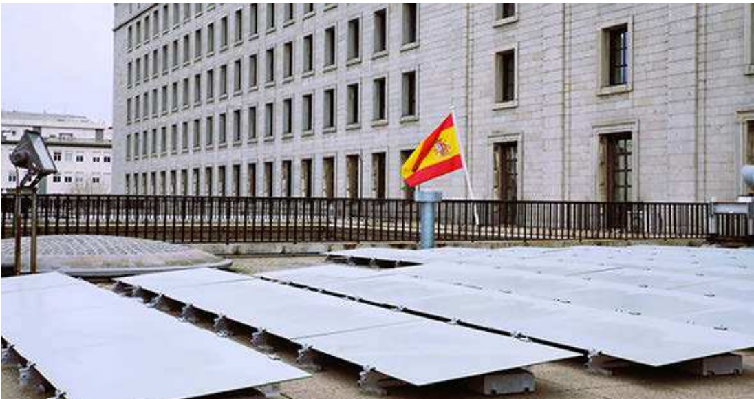
Paneles fotovoltaicos en una de las cubiertas del edificio.
