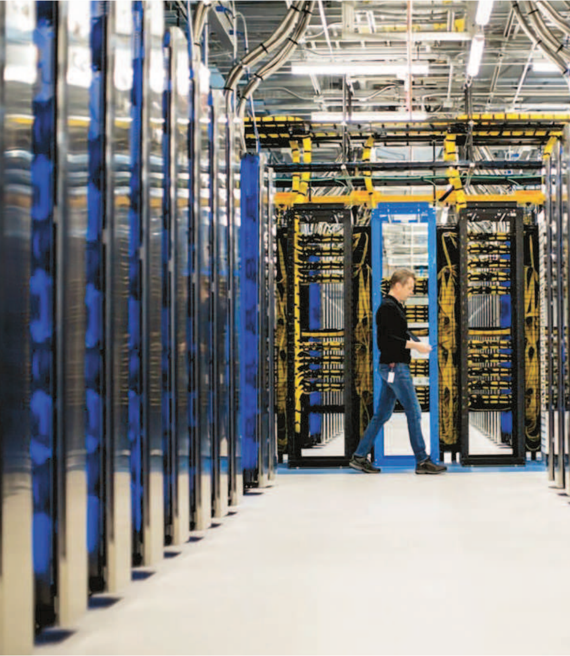
La abundancia de energía renovable disponible es un aliciente para la instalación de centros de datos
