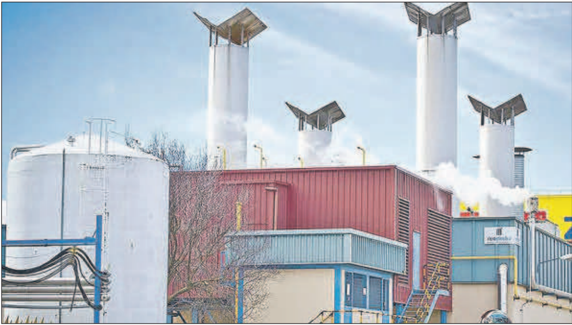
Instalación de Neoelectra. EE
