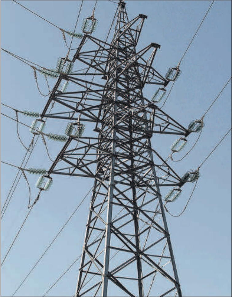
Tendido eléctrico de alta tensión. EE
