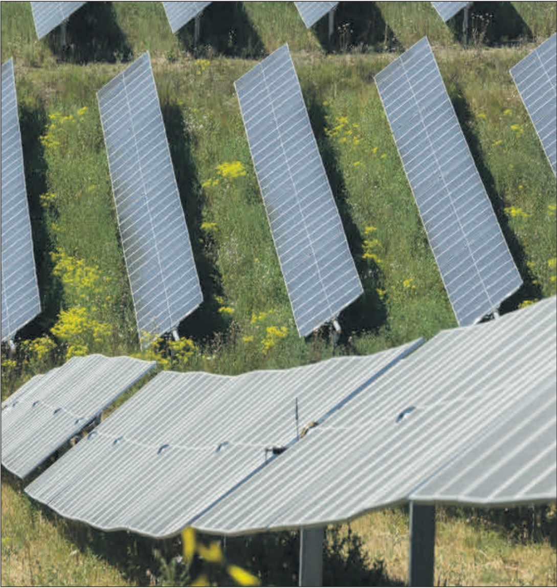
Instalación fotovoltaica en Andalucía. EE
