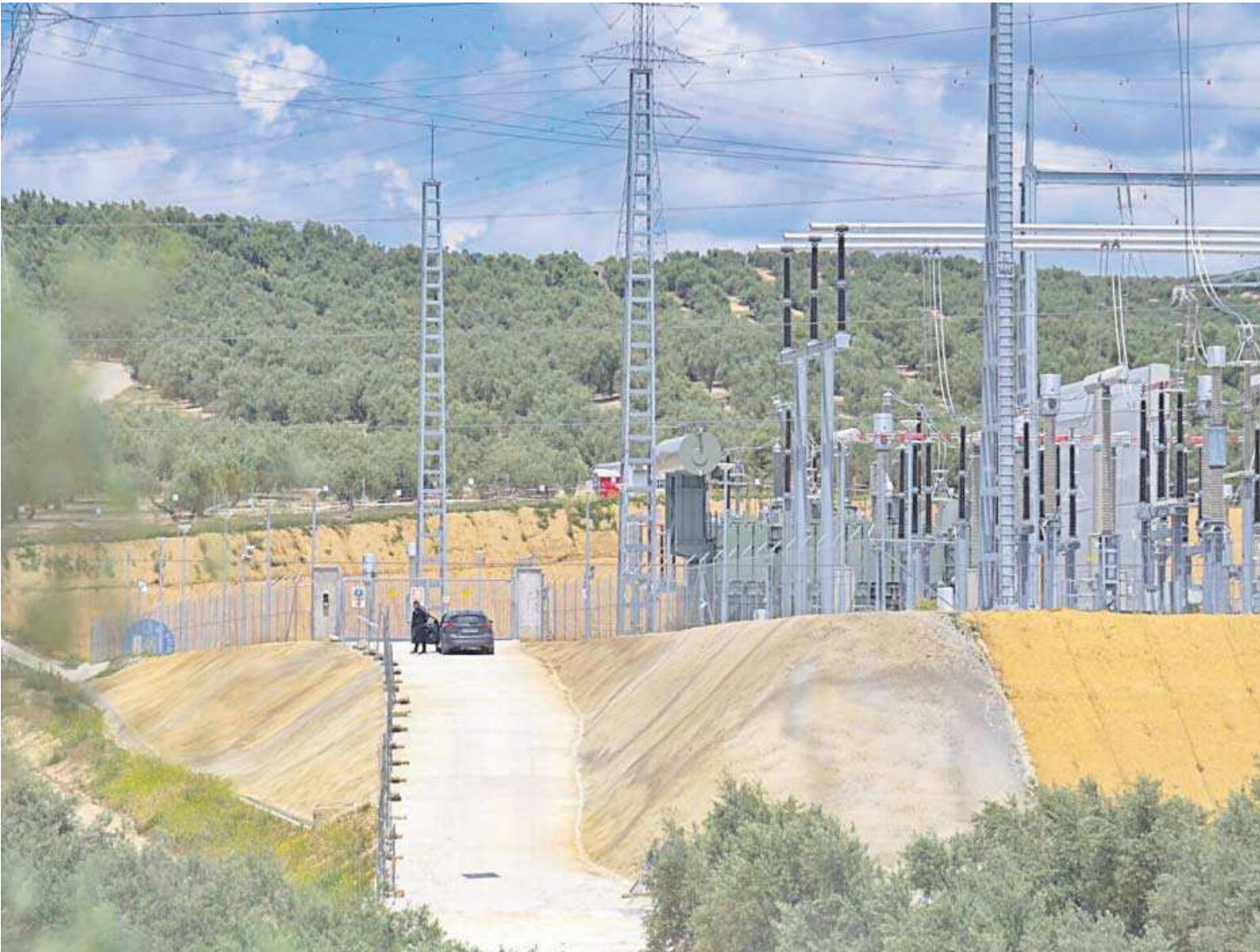
Un operario llega a la subestación eléctrica de alta tensión de Caparacena.
