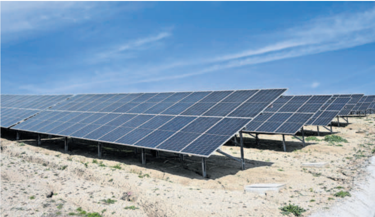
Planta fotovoltaica de la Comunidad de Regantes Santa María Magdalena, de la localidad jienense de Mengíbar. EP
