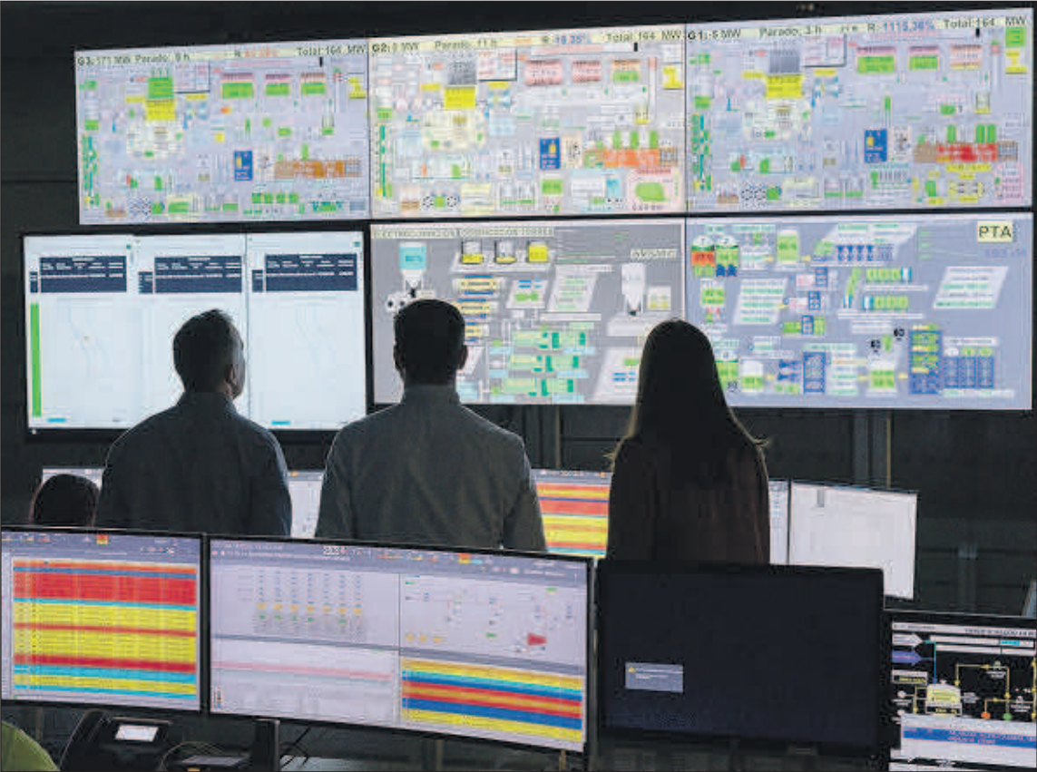
El centro de control de los ciclos combinados. EE
