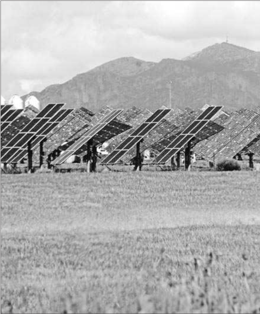
Placas fotovoltaicas con la sierra de Kodes al fondo. Iñigo URIZ | FOKU
