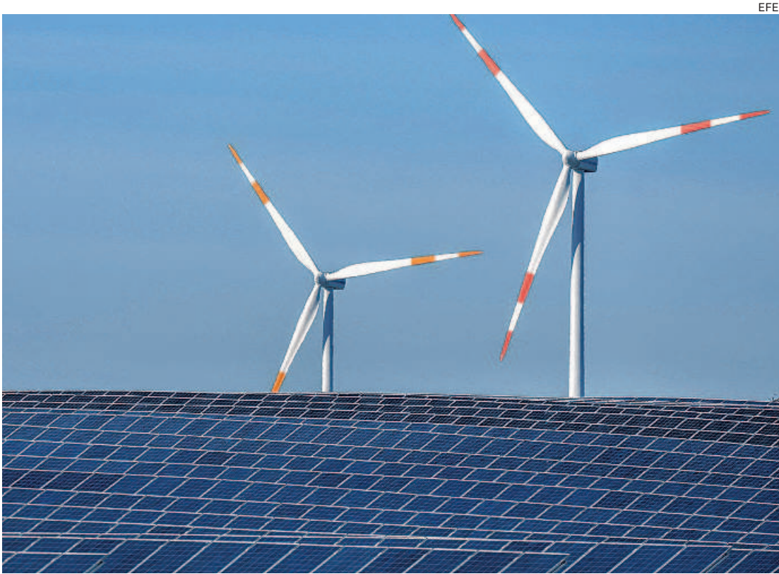
Planta híbrida eólica y fotovoltaica en España
