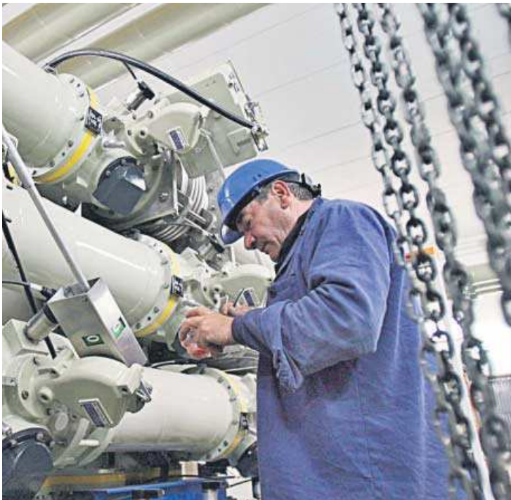
Un operario en la subestación de Guadalhorce.
