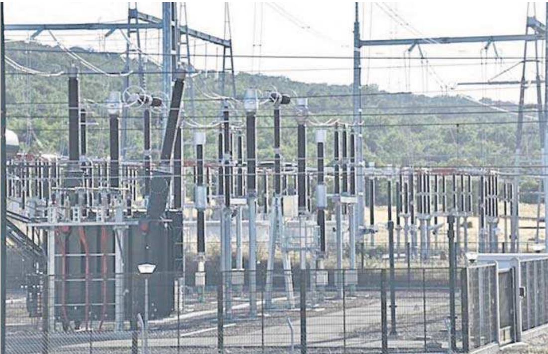
Subestación eléctrica de Ronda.
