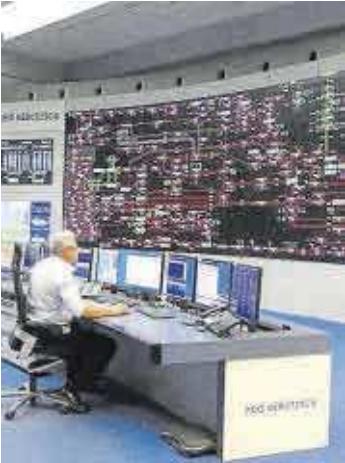
Control de Red Eléctrica.
