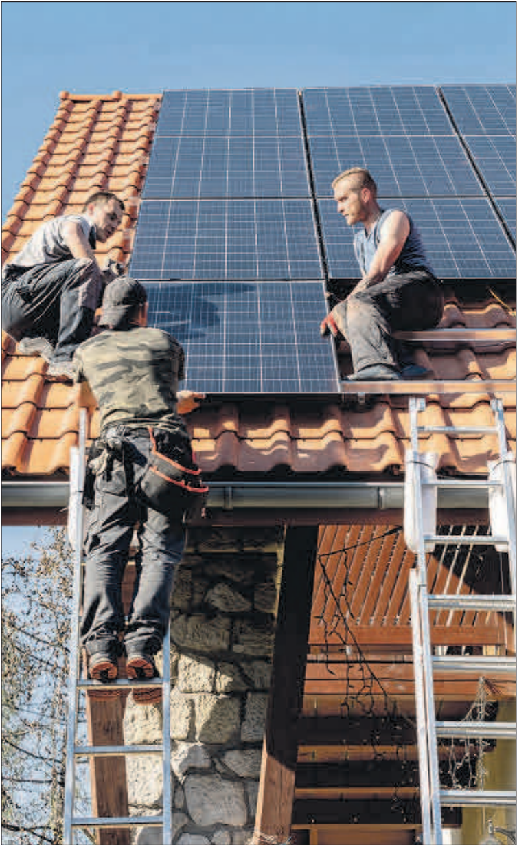
Una instalación de autoconsumo. EE
