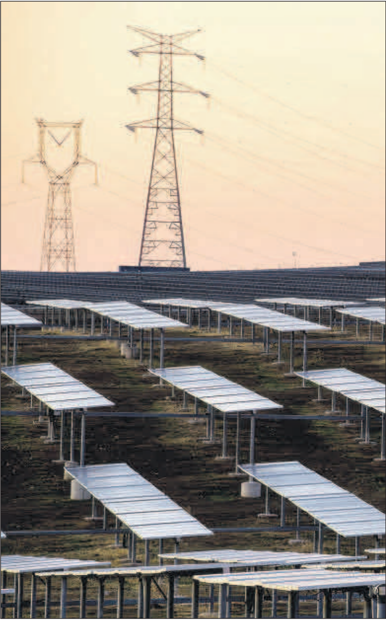
Instalaciones de FRV. EE
