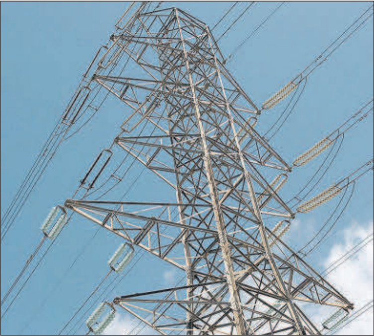
Un tendido eléctrico. EE
